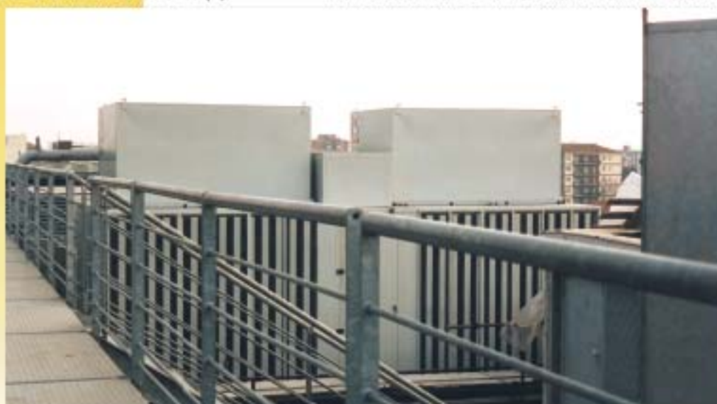
Condizionamento refrigerazione. Cabina afonica per gruppo frigorifero ad aria. Air conditioning/refrigeration. Soundproof cubicle for air refrigeration units.
