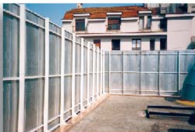
Condizionamento. Barriera acustica per tetti di raffreddamento. Air conditioning. Acoustic barrier for cooling towers.
